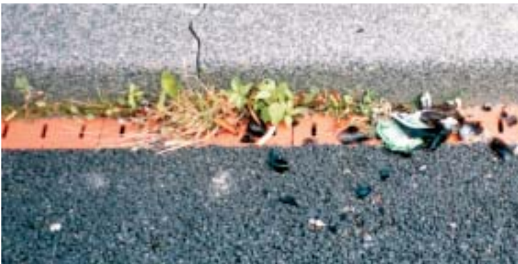
Figuur 9 Onkruid en vuil in afwateringssysteem
