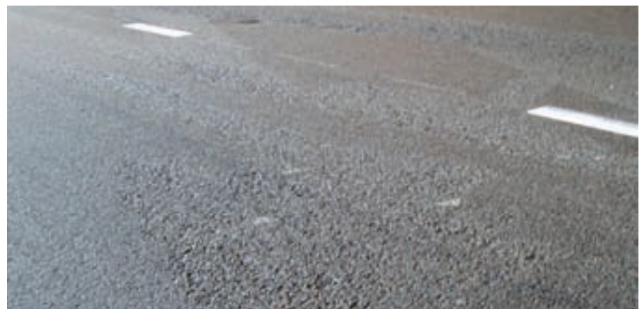
Zodra rafeling zichtbaar wordt graag snel onderhoud uitvoeren. Uiteindelijk goedkoper en beter voor het comfort.
