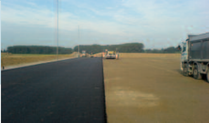
9. Asfaltbeton: snel en goed af te werken. Bijzonder aandacht voor zorgvuldig aanvoer van materieel en materiaal.
