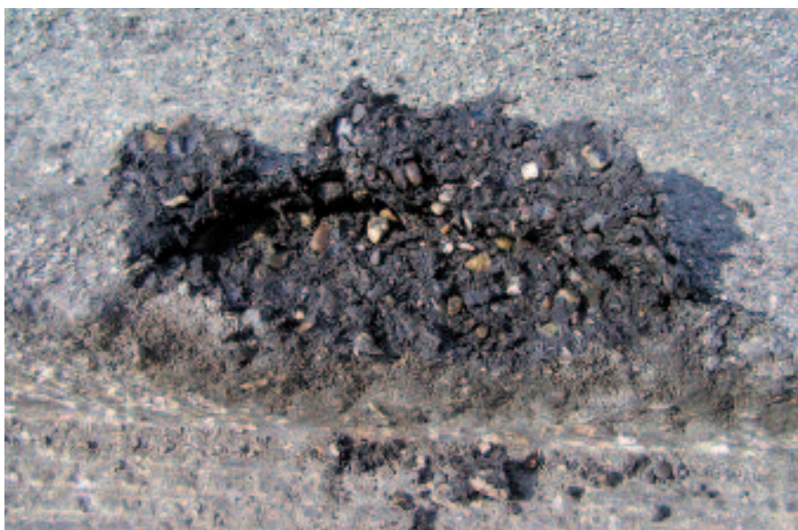
Schade aan oppervlakte.
