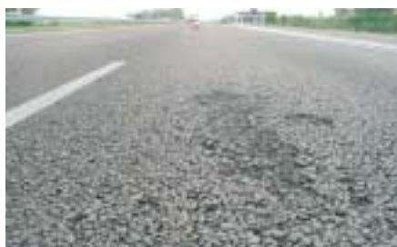
Detail gerafelde zoab; sealen kan proces vertragen maar niet opheffen. Hier is een speciale emulsie-asfaltbeton een mogelijkheid vervanging uit te stellen
