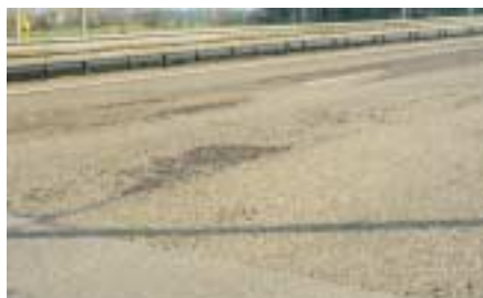
Rafeling is over het algemeen het maatgevende schadebeeld voor onderhoud van ZOAB
