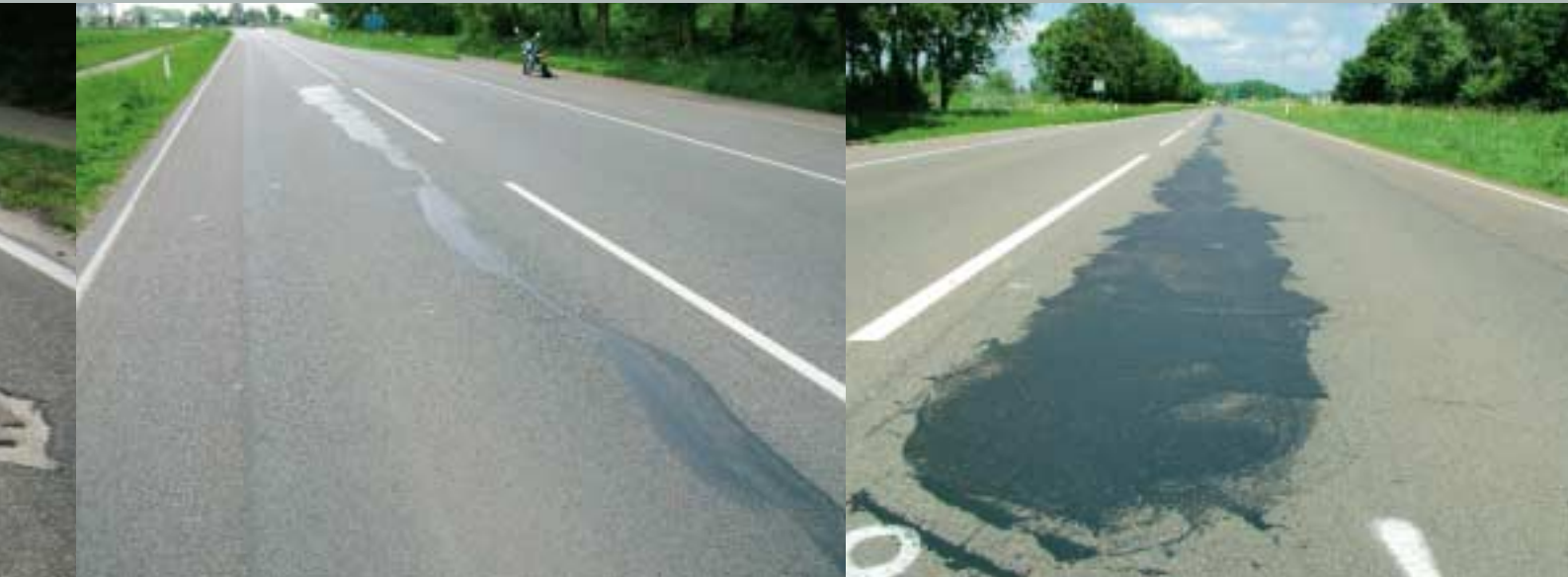
Provisorische reparaties soms levensgevaarlijk
