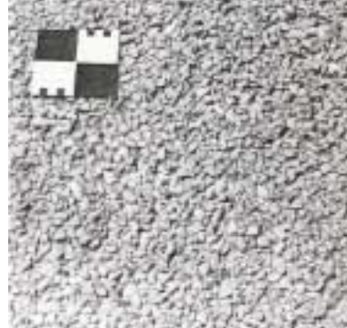
Schadebeeld: lichte rafeling
