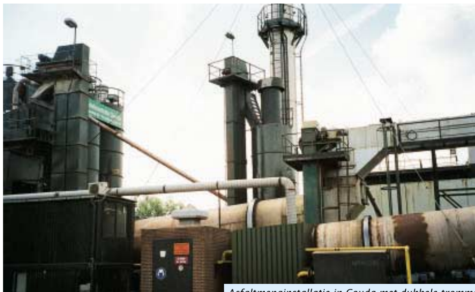
Asfaltmenginstallatie in Gouda met dubbele trommel
