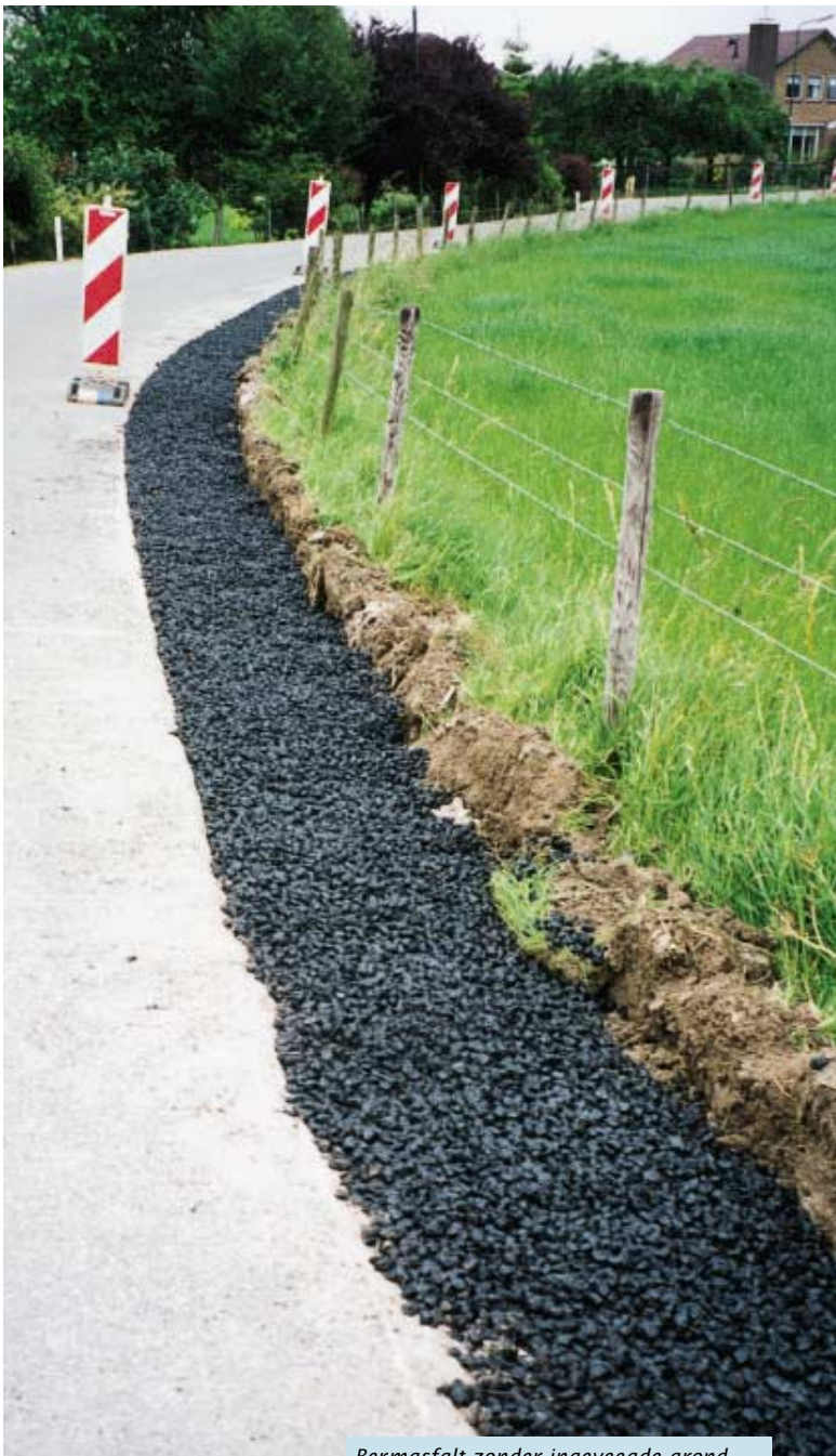
Bermasfalt zonder ingeveegde grond
